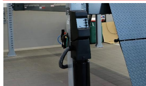
Skrzynka sterownicza na kolumnie
