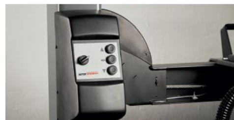
Skrzynka sterownicza na kolumnie
