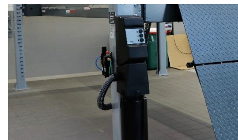
Skrzynka sterownicza na kolumnie
